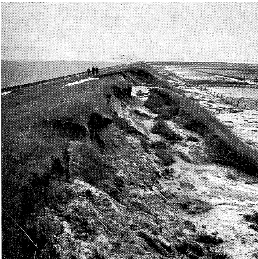
Dijk met aangetast binnenbeloop
